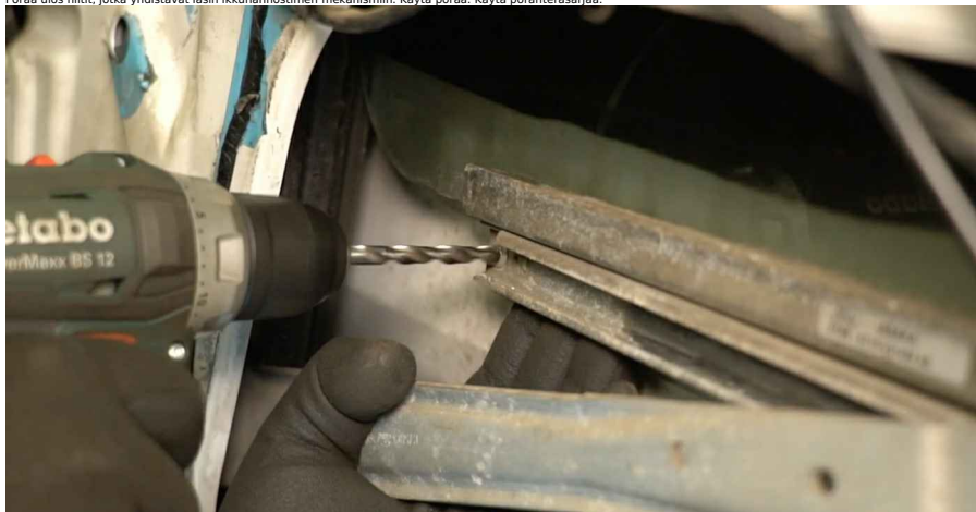
14 Poraa ulos niilit, jotka yhdistävät ikkunannostimen mekanismin oveen. Käytä poraa. Käytä poranteräsarjaa.
